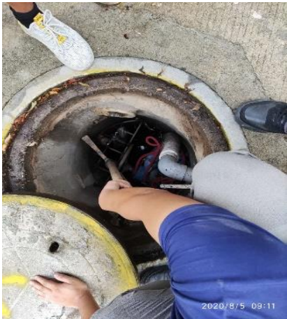
关闭雨水总排口的节流阀
